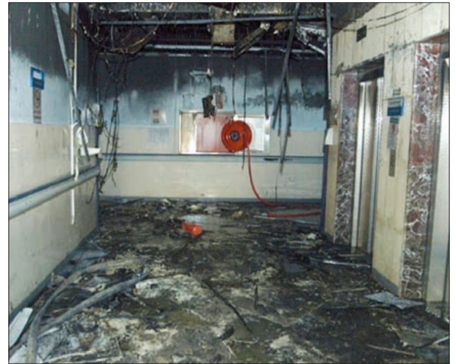
مدخل المستشفى وقد أتى عليه الحريق
