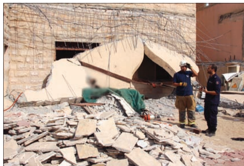
السقف الذي انهار خلال عملية الترميم
