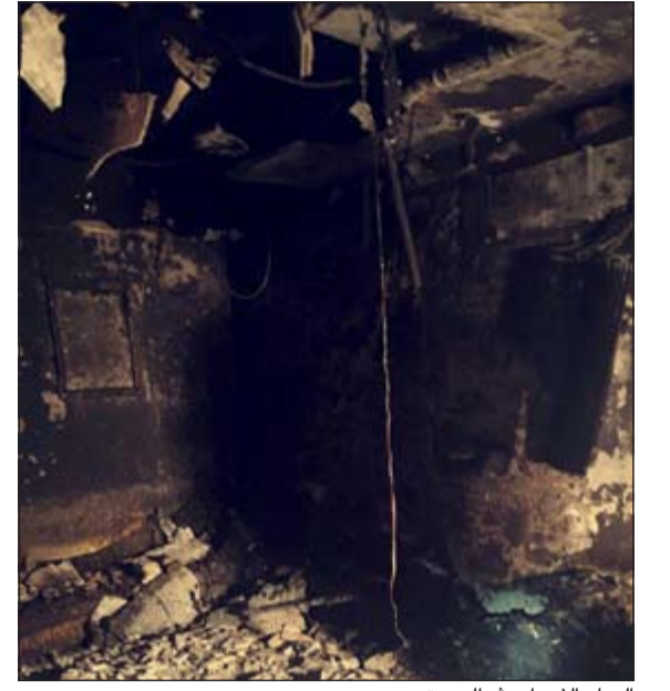
الدمار الذي أحدثه الحريق
