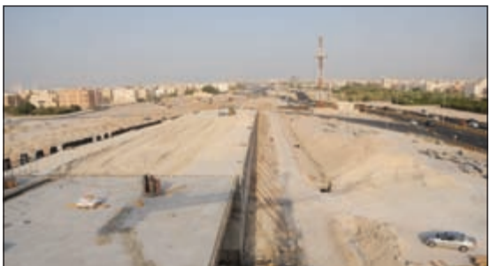
جانب من أعمال طريق الجهراء بالقرب من منطقة التعديلات المقرة في خطوط المياه (هاني الشمري)
