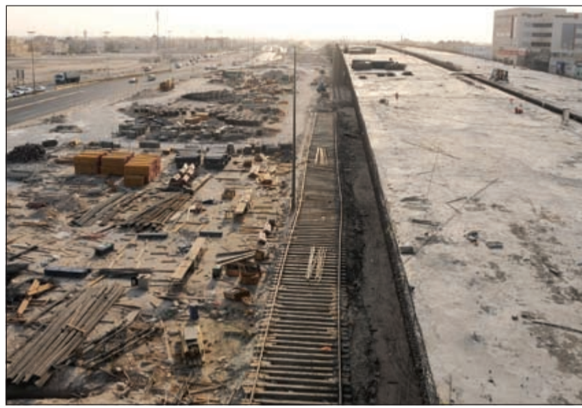
جانب من أعمال طريق الجبراء والذي يستدعي تعديلات في خطوط المياه التي تغذي المناطق المجاورة (فاتي الشمري)
