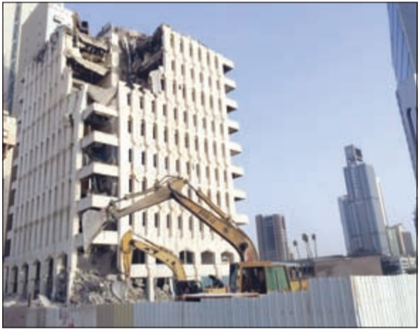
الجزء المنهار من المبنى
