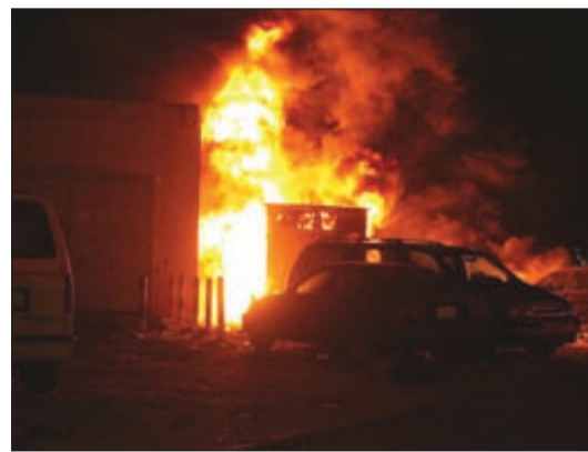
حريق المحول تم التعامل معه بعد فصل التيار الكهربائي
