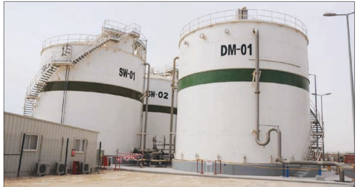
جانب من محطة الزور الجنوبية
