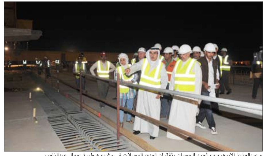
م.عبدالعزيز الإبراهيم وم.أحمد الحصان يتفقدان إحدى الوصلات في مشروع طريق جمال عبدالناصر
