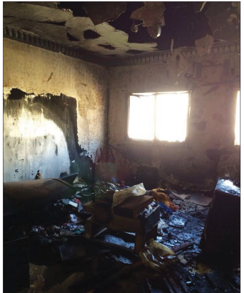
الحريق دمر المنزل بالكامل
