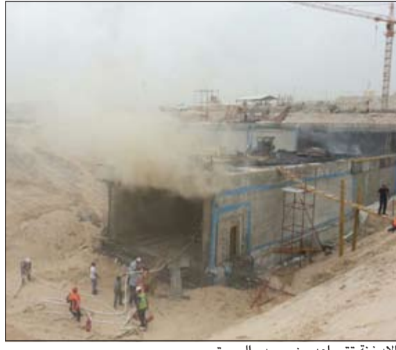
الادخنة تتصاعد من مصدر الحريق
