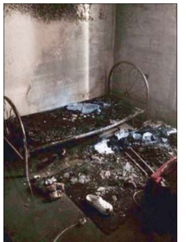
آثار الحريق في الغرفة
