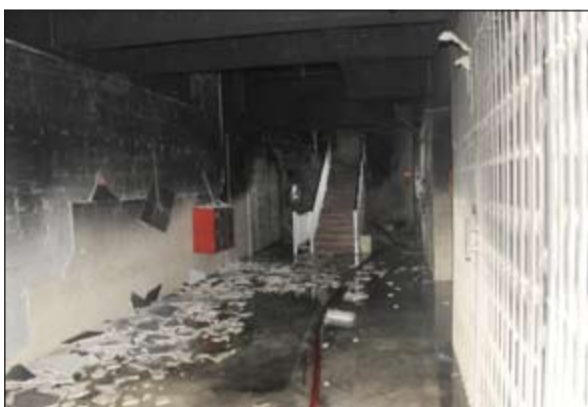
الغرفة ويبدو آثار الحريق
