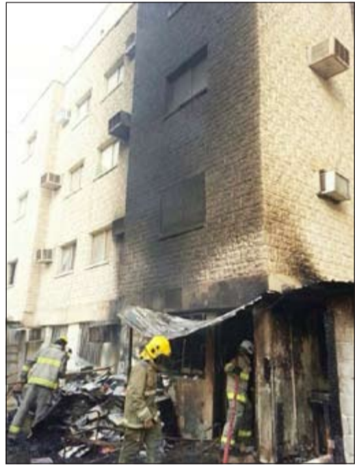
آثار الحريق كما بدت على واجهة البناية
