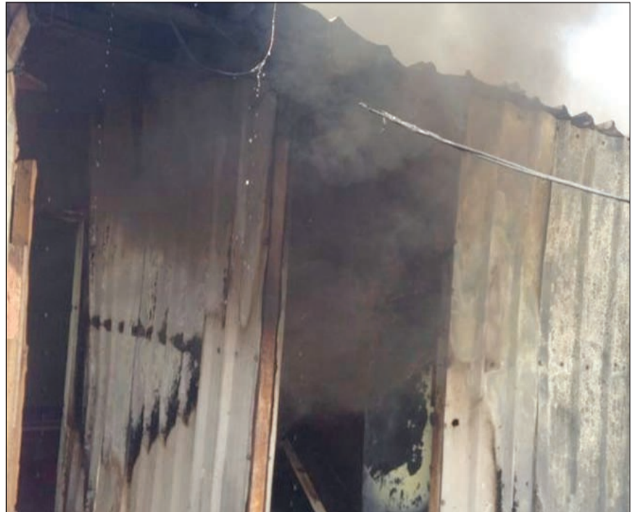
آثار الحريق تبدو على واجهة المطبخ
