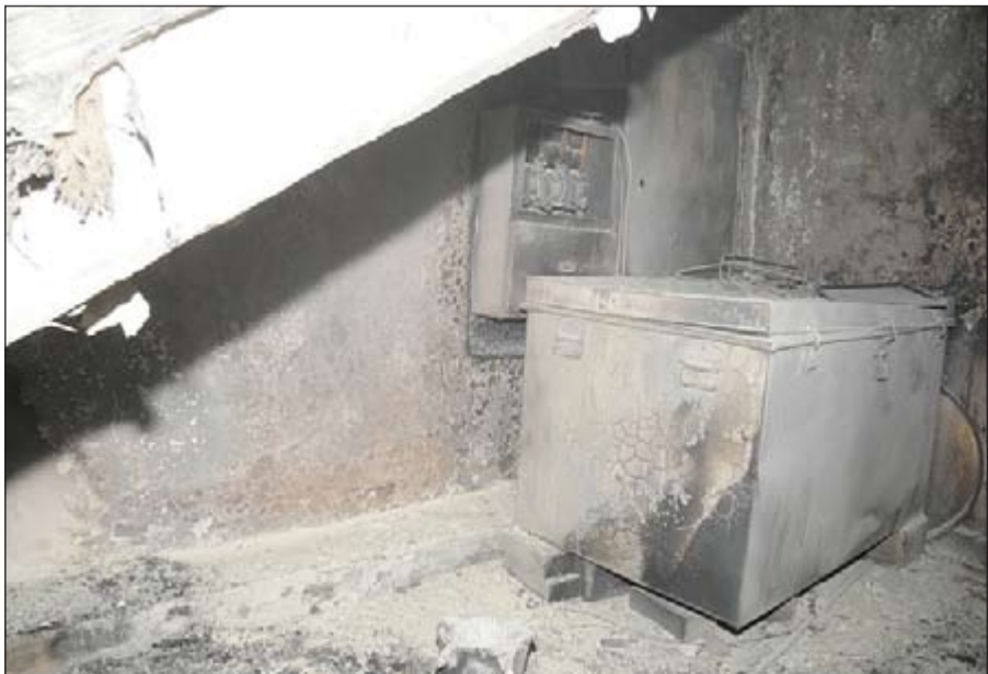
حريق المحول دفع رجال الإطفاء إلى إخلاء البناية
