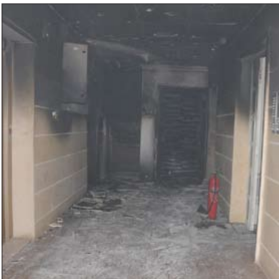
الحريق بدأ في محول كهربائي
