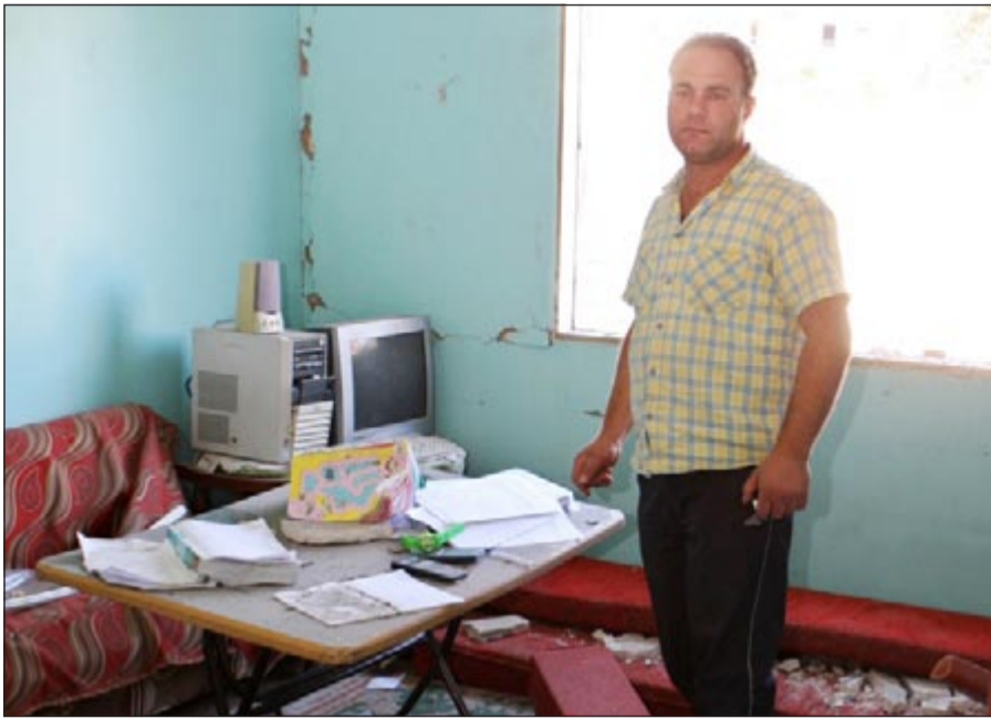
جانب من الخسائر التي لحقت بأحد المنازل في بعلبك بعد قصف المعارضة السورية للمدينة
