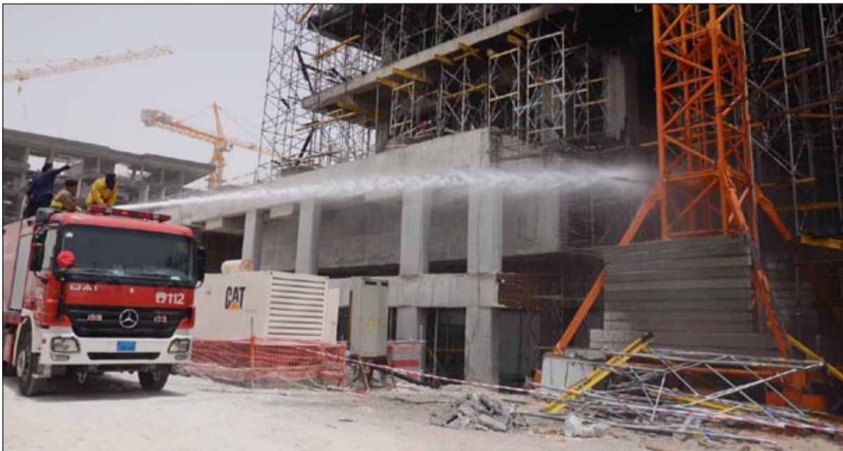
الإطفاء تحاول إخماد الحريق في المبنى
