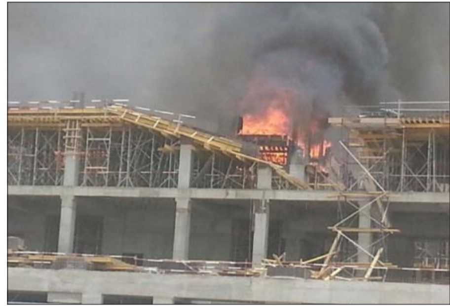
الحريق في المبنى الثاني المكون من دورين
