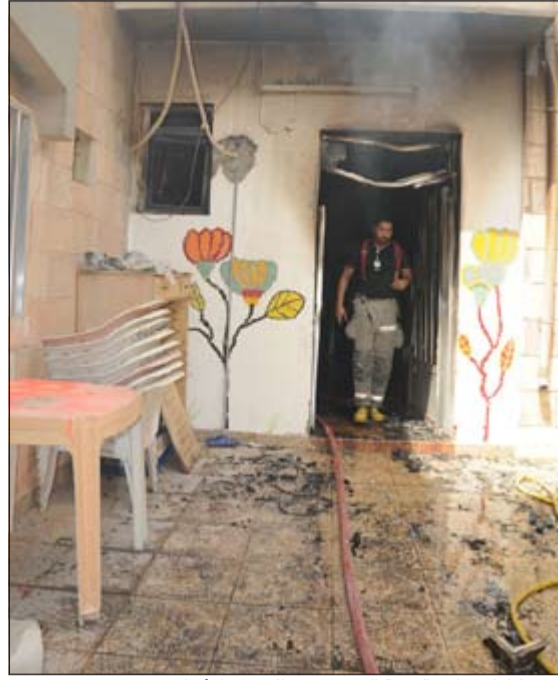
رجل إطفاء يعاين الغرفة التي شهدت الحريق المساري
