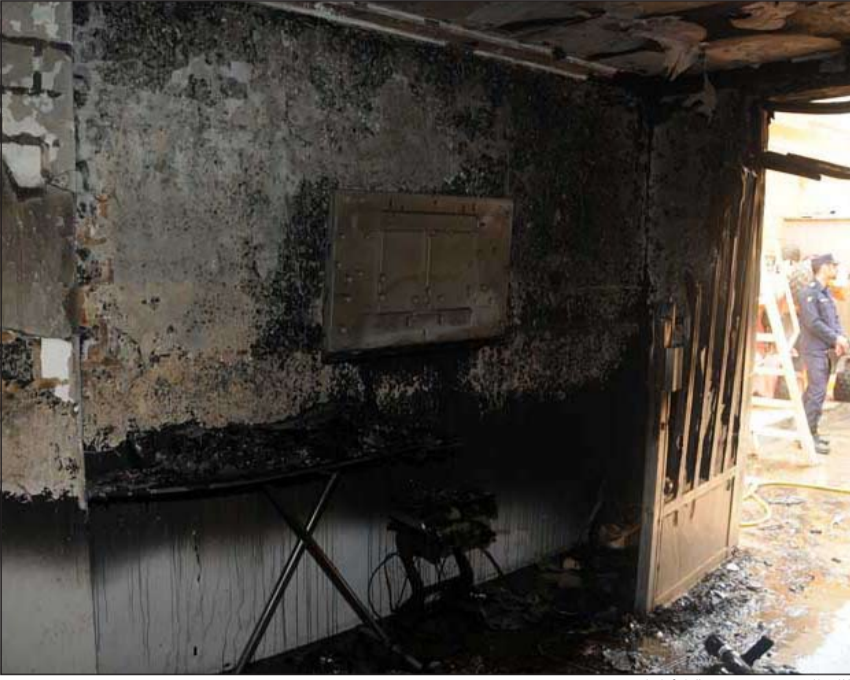
آثار الحريق في غرفة الأطفال
