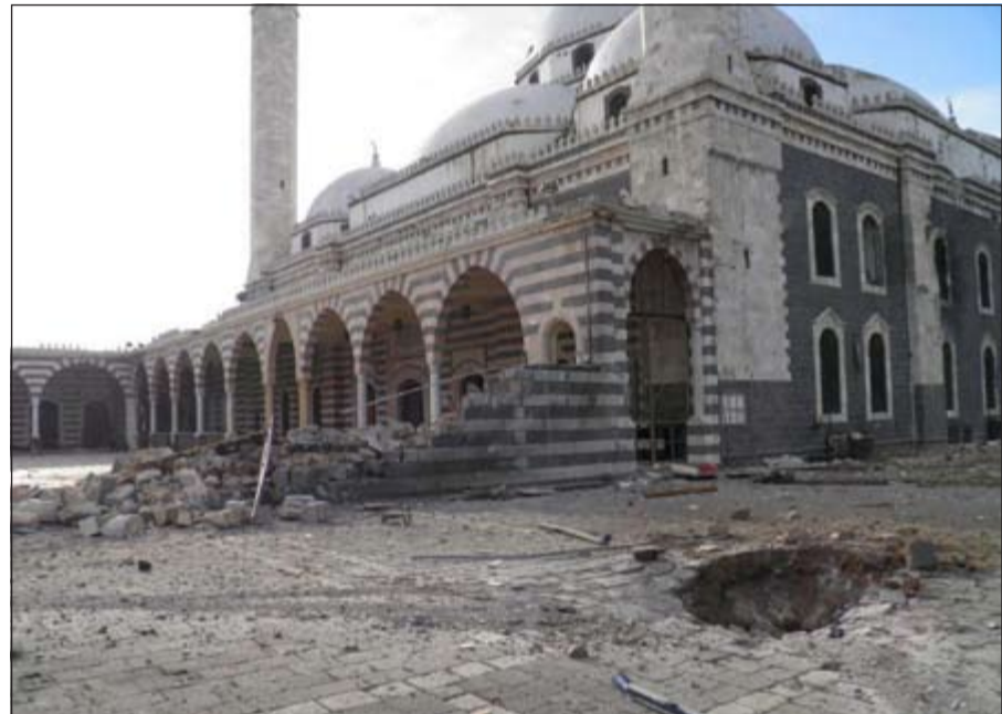
الدمار الذي حل بمسجد الصحابي الجليل خالد بن الوليد في حمص نتيجة قصف النظام
