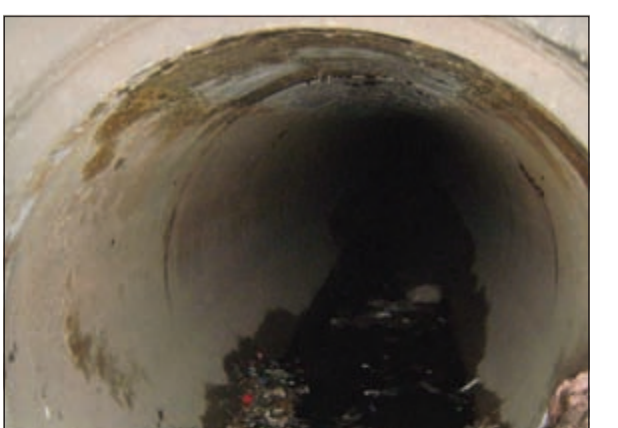
خطوط صرف صحي سدت بأكياس الأنقاض
