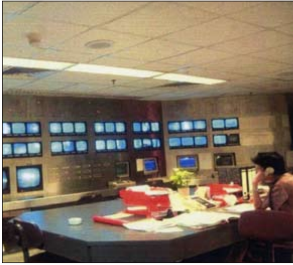
غرفة التحكم الرئيسية ومراقبة سير خطوط المترو تحت الأرض
