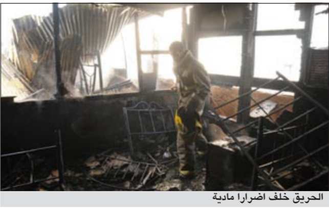
الحريق خلف اضرارا مادية
