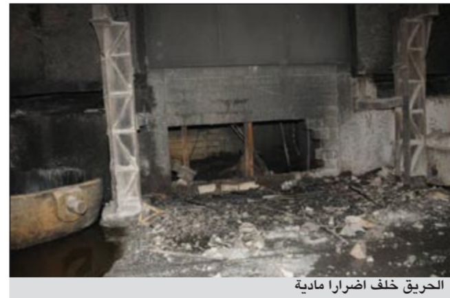
الحريق خلف اضرارا مادية
