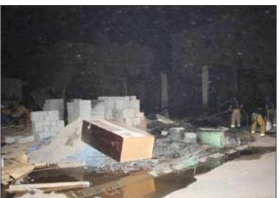
آثار الحريق في المنزل قيد الإنشاء
