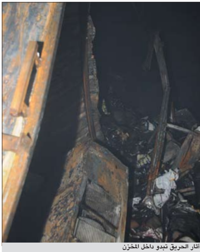
آثار الحريق تبدو داخل المخزن
