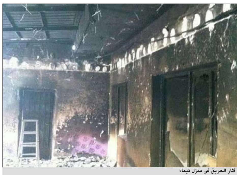
آثار الحريق في منزل تيماء
