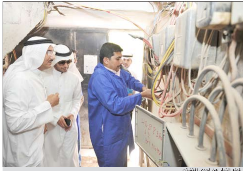
قطع التيار عن إحدى المنشآت
