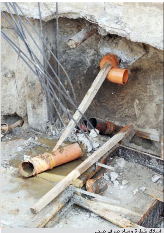
أسلاك خطرة ومياه صرف صحي
