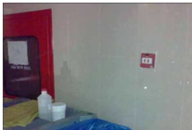
مفتاح إنداز الحريق بعد إتلافه
