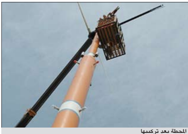
المحطة بعد تركيبها
