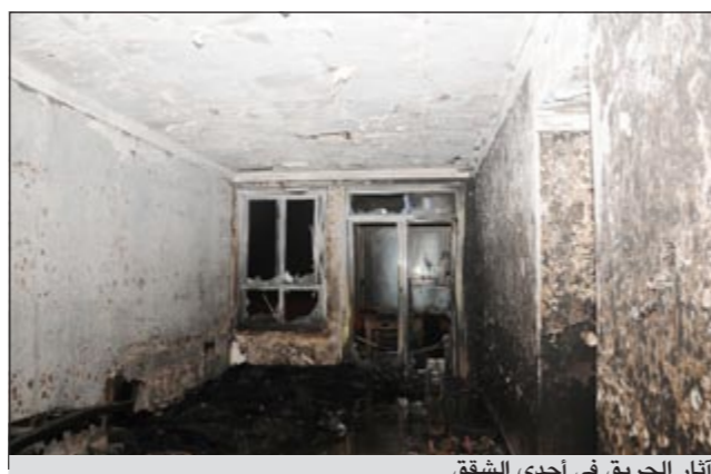
آثار الحريق في إحدى الشقق
