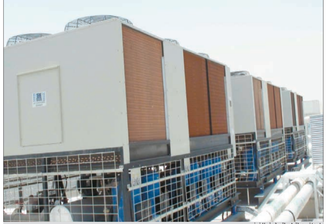
اجهزة حديثة لمحطة مشرف للضخ
