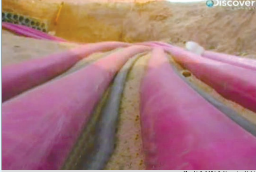
كابلات كهربائية لتغذية المدينة
