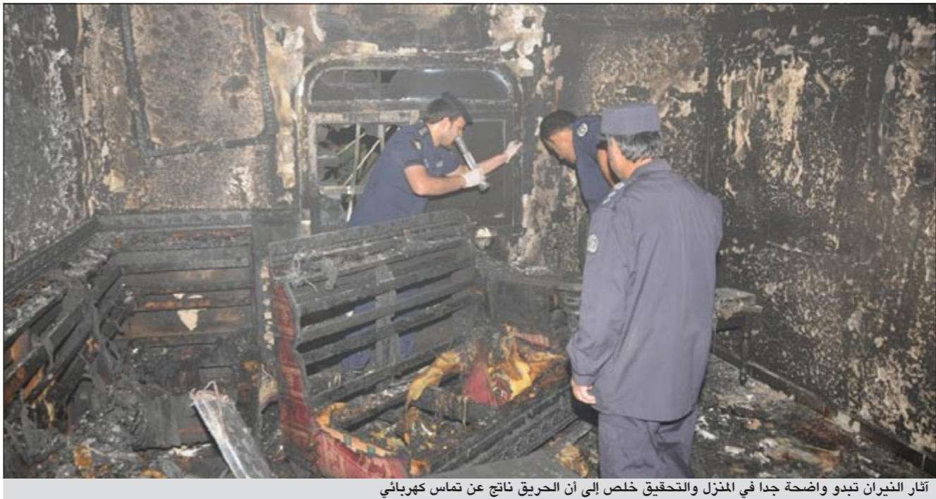
آثار النيران تبدو واضحة جدا في المنزل والتحقيق خلص إلى أن الحريق ناتج عن تماس كهربائي
