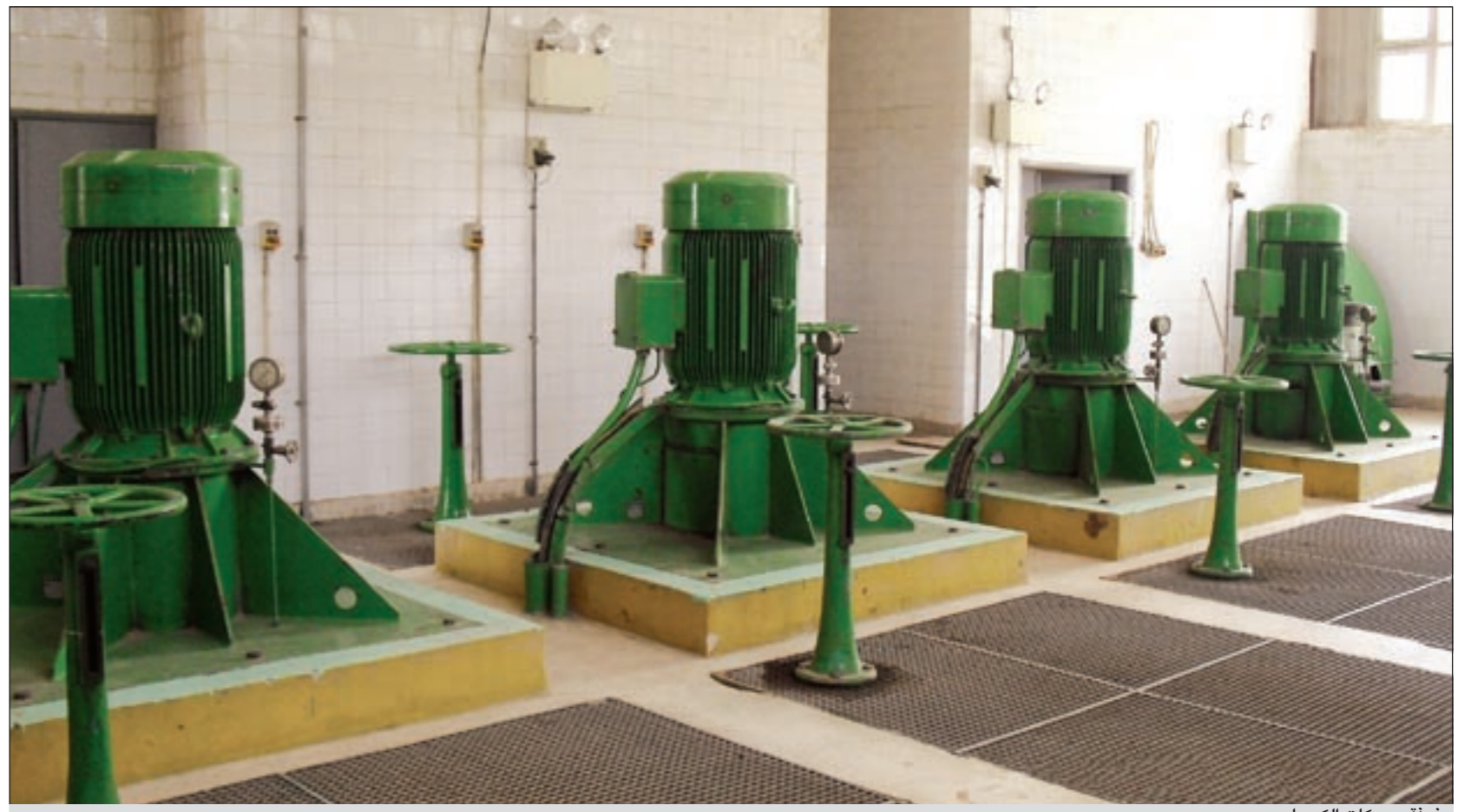
غرفة محركات الكهرباء
