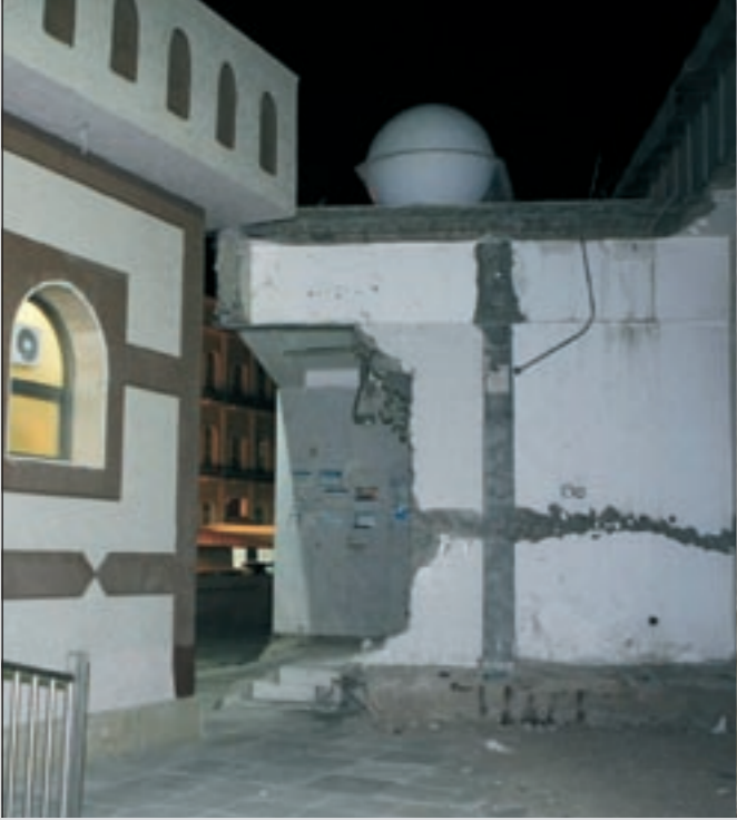
المبنى بحاجة ماسة إلى إعادة ترميم
