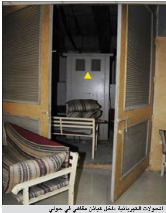
المحولات الكهربائية داخل كبائن مقاهي في حولي
