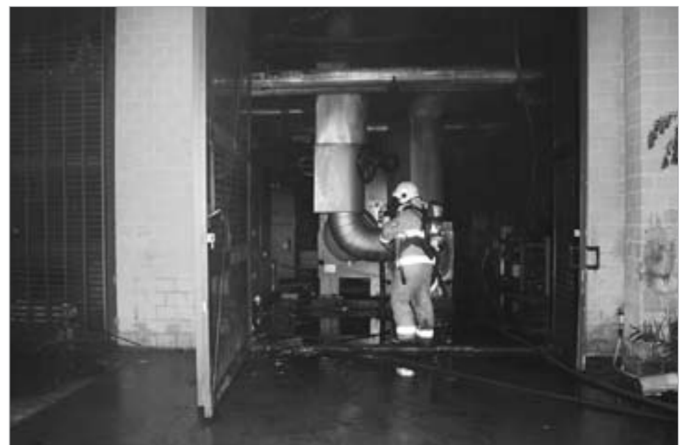
رجال الإطفاء يعالين غرفة الكهرباء المحترقة قرب المسجد الكبير
