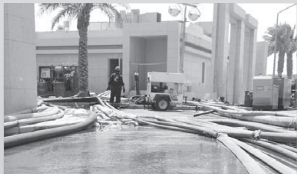
طفح المجاري بعد تعطل محطة مشرف
