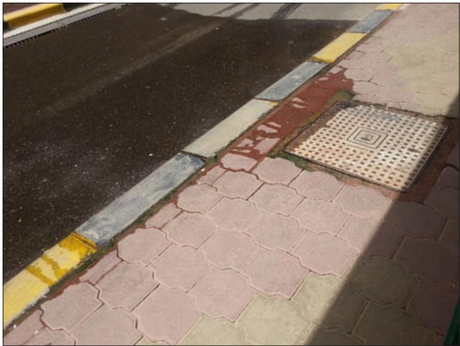
مياه الصرف الصحي مشكلة كبيرة تواجه المدرسة
